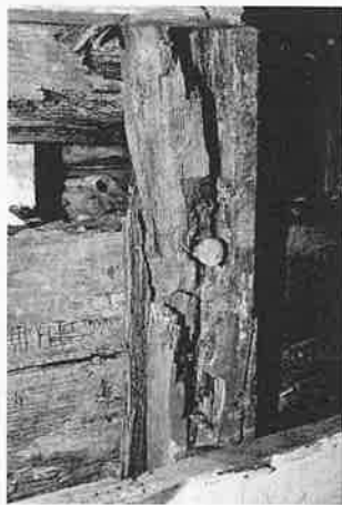
木材の腐朽部材
