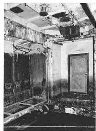
機関室上部の鉄部状況
